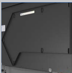
Panel inspekcyjny umożliwiający dostęp do filtrów G3/F7 i wymiennika odzysku ciepła
